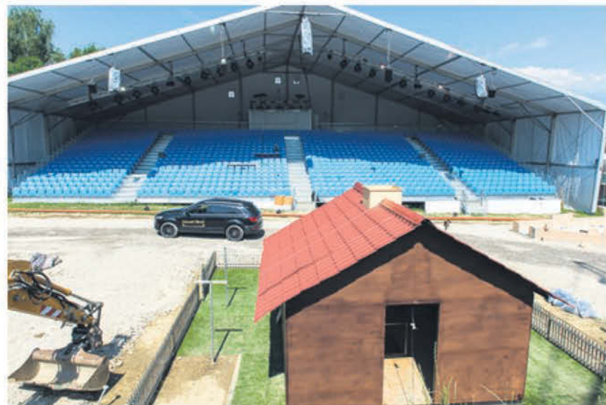
Le chantier où aura lieu le spectacle. Au premier plan, la maison de Justine qui refuse de céder sa parcelle au promoteur immobilier Gérard Bicod.
